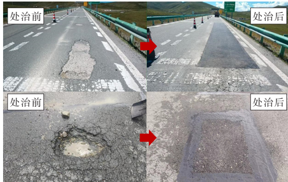
图 11 G0615 德马高速翻浆病害处治前后的照片
