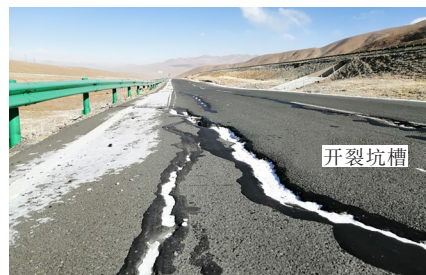
图2 道路开裂坑槽病害照片
