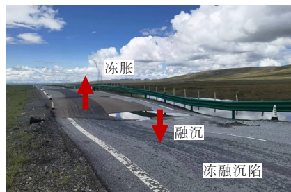
图1 道路冻融沉陷病害照片
