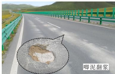
图3 道路唧泥翻浆病害照片
