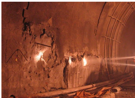
图 8 拱脚开裂+钢拱架变形
