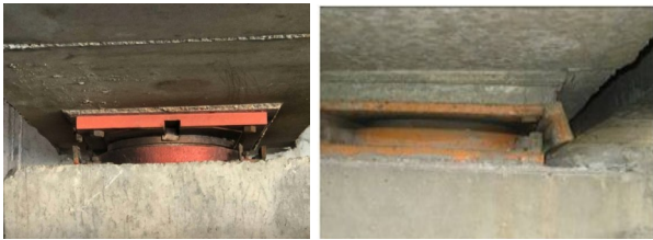
图1 单向支座导轨和限位槽卡死或限位板损坏
