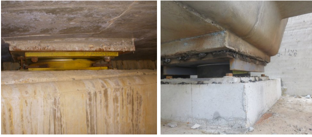
图9 支座安装方式错误不利于养护、更换
