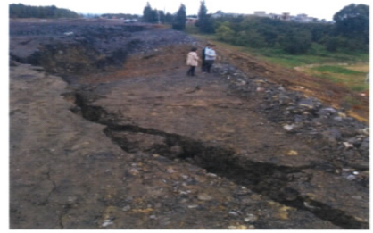
(a) 路堤拉裂
